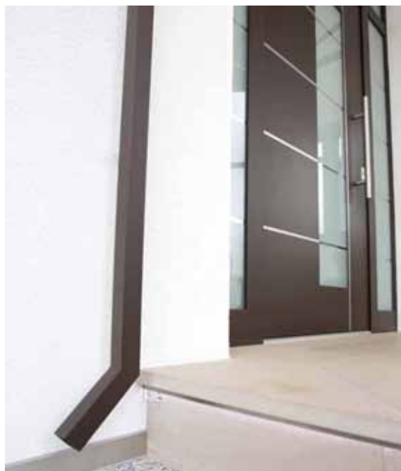
Regenwasser kann durch ein Fallrohr abgeleitet werden.
